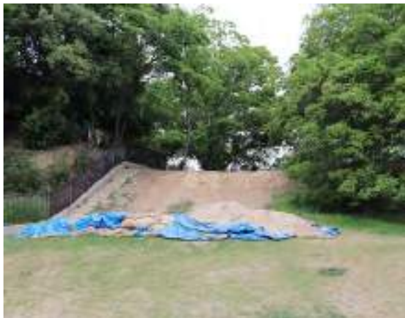
墳丘の土流出状況
